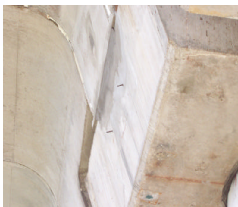
Figura 2: Varillas expuestas al ambiente
