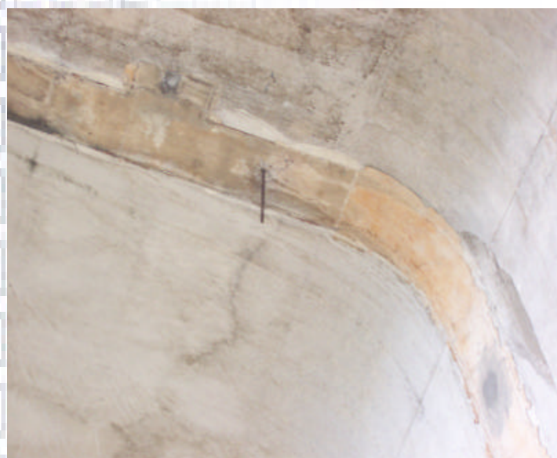
Figura 3: Varillas expuestas al ambiente
